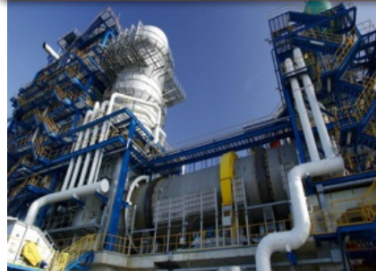
廃棄物発電施設
