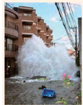
図表 1.6 老朽化に起因する水道管の破損事故
