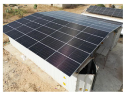
太陽光発電によるオフグリッド型冷凍冷蔵貯蔵コンテナ
