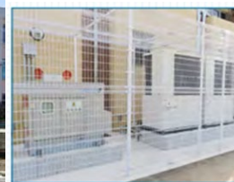
GHP及び非常用発電機
