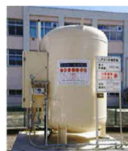
LPガスタンク
