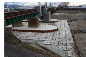
鉄道橋りょうの流失・傾斜対策
