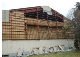
外壁の全面的な脱落事例
