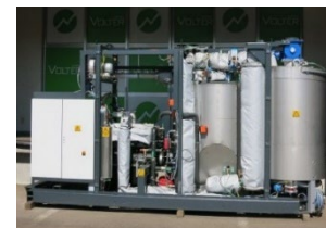
木質バイオマス利用 熱電併給装置
