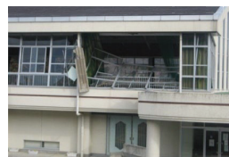
横連窓の障子ごとの脱落
