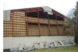
外壁の全面的な脱落
