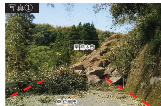
▲写真① 国道445号の被災状況（H28.4熊本地震）
