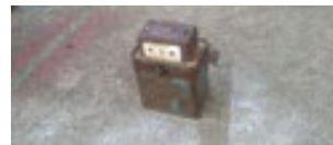
配電盤から発見されたPCB含有低圧進相コンデンサー
