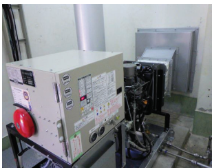
整備した非常用電源設備
