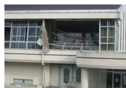
横連窓の障子ごとの脱落
