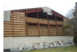
外壁の全面的な脱落
