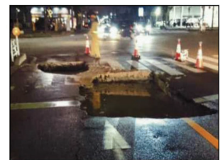
下水道に起因した道路陥没
