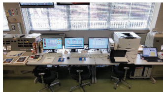
ダム管理用制御処理装置更新
