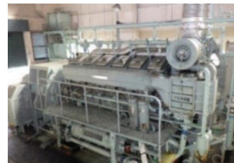
【停電対策の例：自家発電機】
