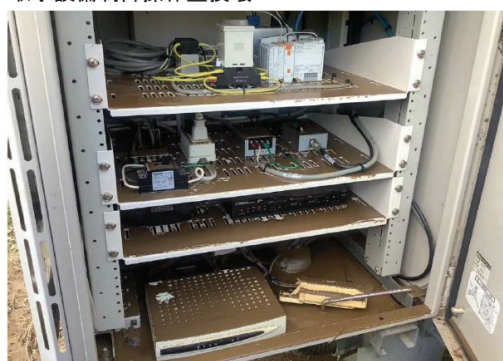
取水設備制御操作盤損壊
