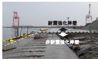
東日本大震災で被災した仙台塩釜港の一般岸壁と耐震強化岸壁
