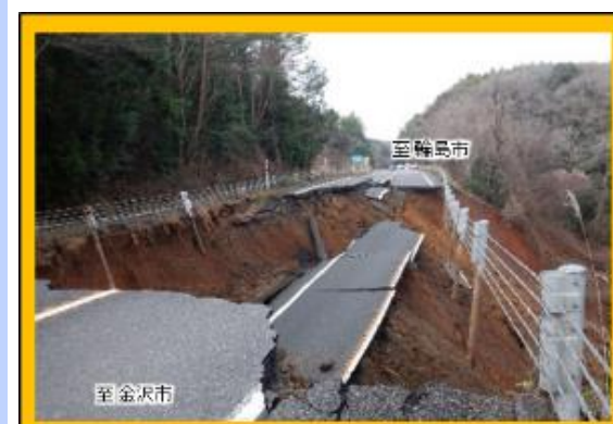
写真③ 能越自動車道の道路崩壊
