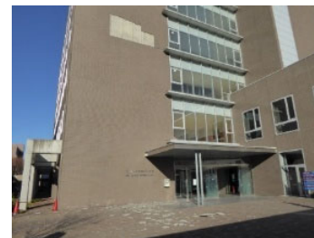
外壁の剥離、落下
