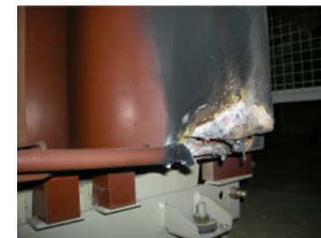
変圧器の発火による損傷
