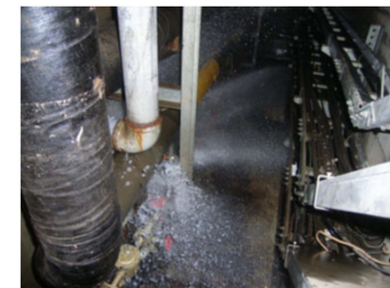
配管の破損による水漏れ
