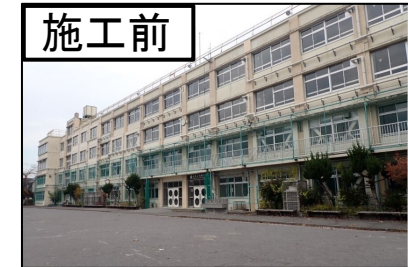
【参考：老朽化した学校施設の劣化状況の一例】
