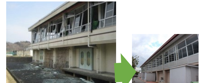
地震によりガラスが落下
