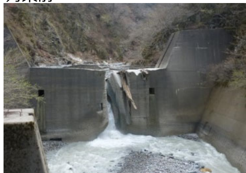
常時流水の影響による摩耗の進行
