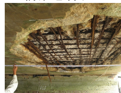
床版鉄筋露出
