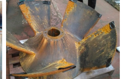
排水機場（羽根車の劣化）
