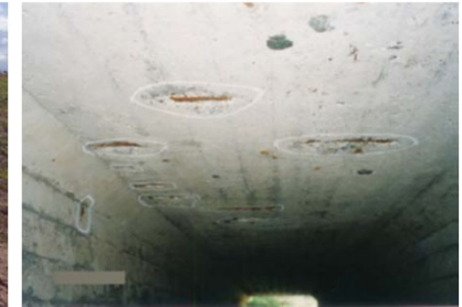
樋門・樋管（鉄筋の露出・腐食）
