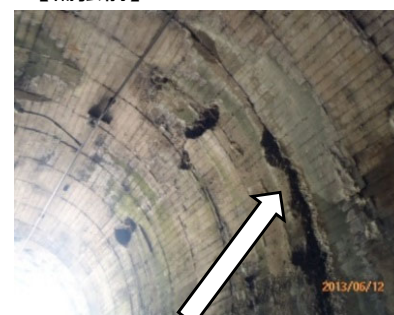
ひび割れの発生
