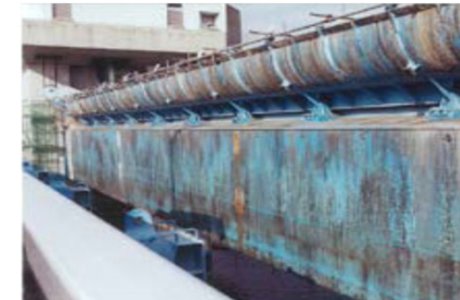
水門（ゲート塗装の劣化）
