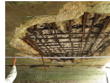
床版鉄筋露出
