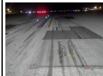
(老朽化した滑走路舗装)
