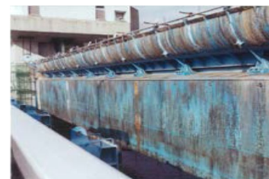
水門(ゲート塗装の劣化)
