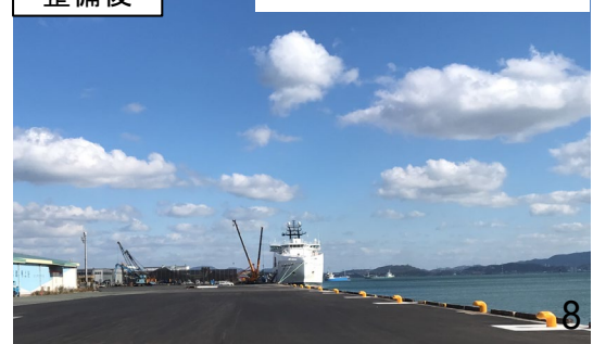
エプロンのクラック、沈下回復状況
