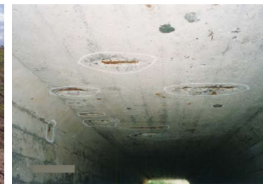
樋門・樋管(鉄筋の露出・腐食)
