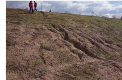
堤防（法面の浸食）
