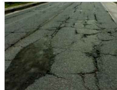
アスファルト舗装ひび割れ
