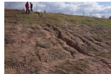
堤防(法面の浸食)
