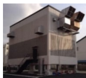
非常用自家発電設備のイメージ
