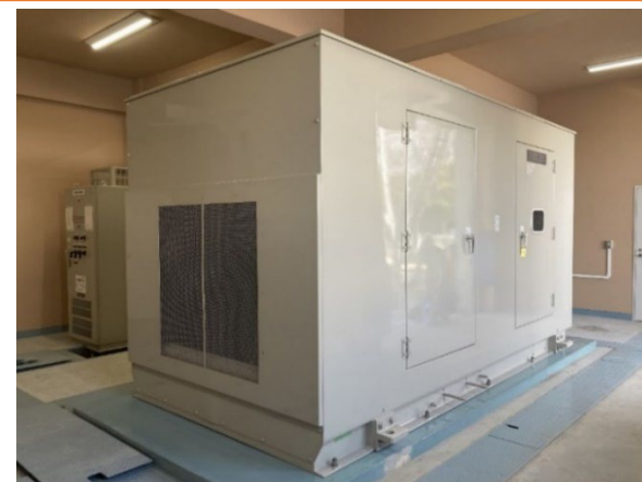
非常用自家発電設備
