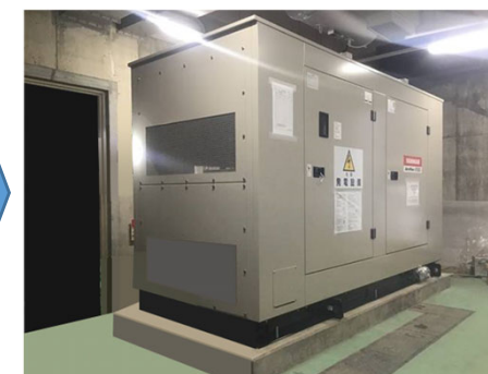
自家発電設備(改修後): 自家発電設備の容量の確保等
