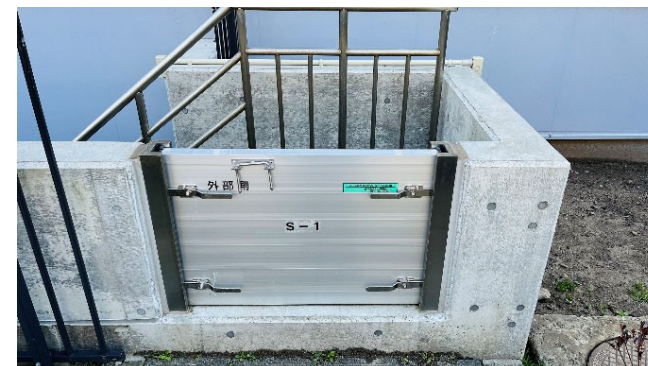
止水板設置: 地下階に設置している受変電設備、 自家発電設備の浸水を防ぐため設置
