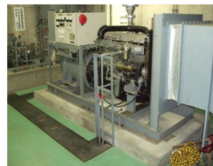
自家発電設備(改修前)
