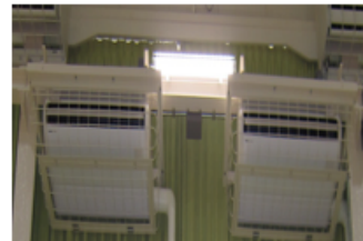
エアコン(室内機)
