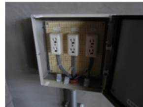
非常用コンセント
