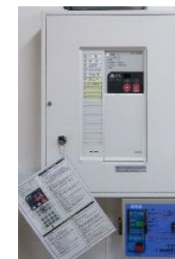
自動火災報知設備 (受信機)
