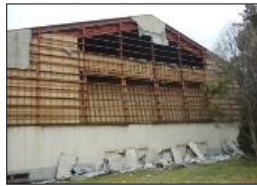
外壁の全面的な脱落事例
