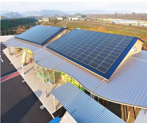
避難施設へ設置した太陽光発電設備
