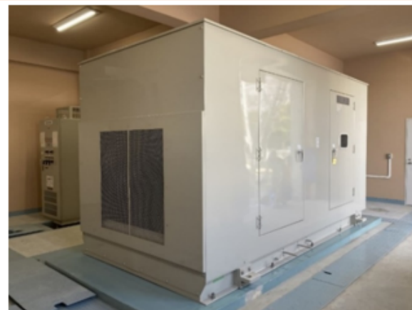
非常用自家発電設備
