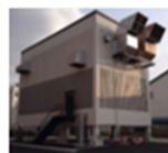
非常用自家発電設備のイメージ
