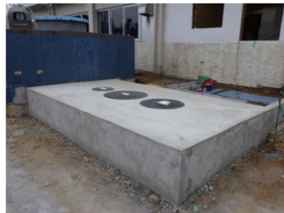
地下燃料タンク
