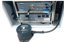
新型強震観測装置 (上:AD・電源装置、下:換波器)
