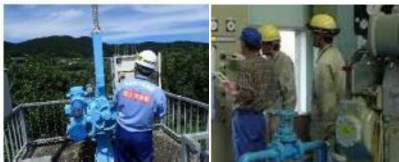
施設ごとに機械操作盤により操作
