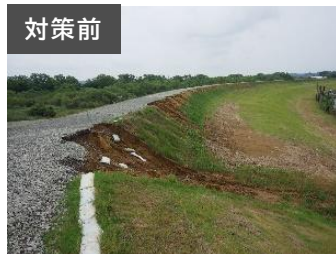
雨水により侵食した堤防法面
