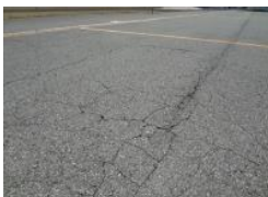
老朽化した基本施設舗装
