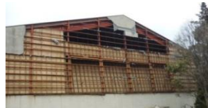
外壁の全面的な脱落
