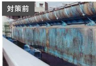
腐食が進行した堰ゲート
