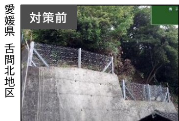
愛媛県 舌間北地区 急傾斜地崩壊防止施設 整備から約30年が経過し、対策施設の老朽化が進行
