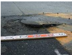
老朽化した舗装により航空機の遅延が発生
