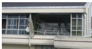
横連窓の障子ごとの脱落
