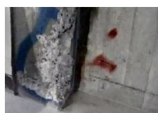
構造躯体の耐久性向上
