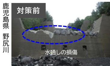
鹿児島県 野尻川 1号堰堤 水通しの損傷
