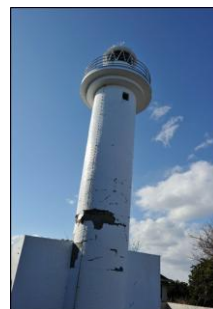
地震で損壊した灯台 (茨城県北茨城市)
