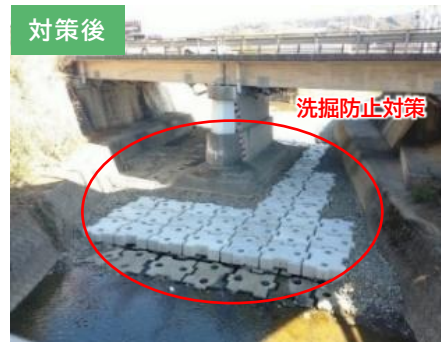
護床ブロックによる洗掘対策
