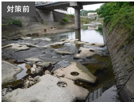
護床ブロック散乱・流出
