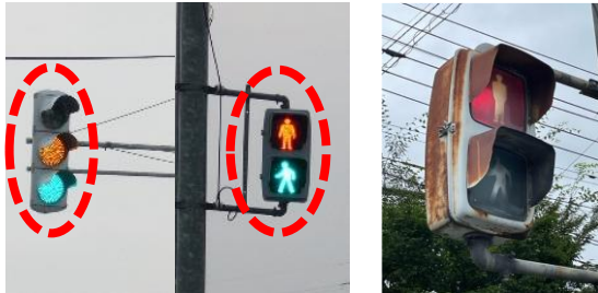
灯火異常(同時点灯)
