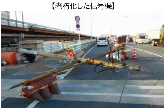
信号柱の倒壊
