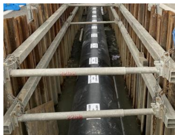
管路の耐震化
