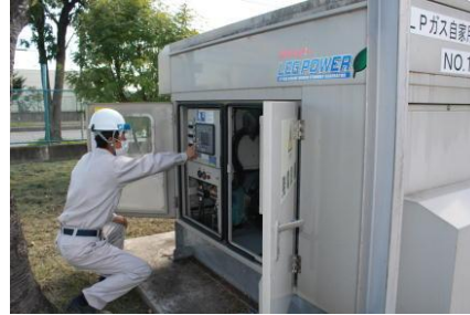
非常用発電機の設置
