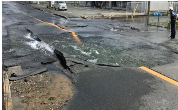
大阪府北部を震源とする地震における送水管の破損現場
