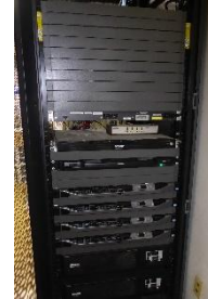
電力監視設備
