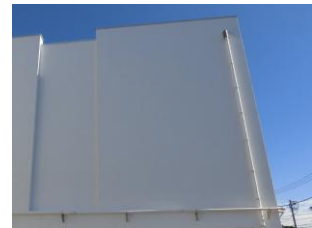
外壁剥離等の落下対策
