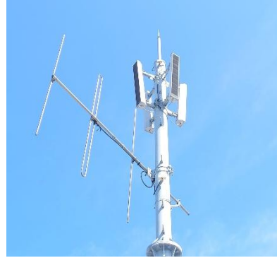
<防災行政無線 屋外スピーカー>
