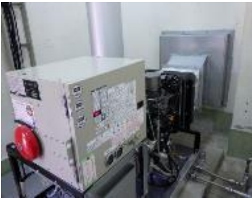
災害に伴う停電発生時においても、非常用電源設備からの給電により、通信体制を確保
