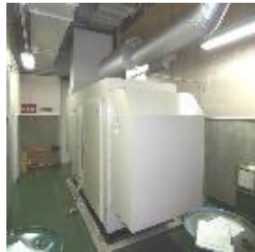
非常用発電機
