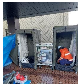
シャワーブース設置状況
