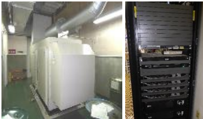
災害対応に不可欠な非常用自家発電設備の整備
