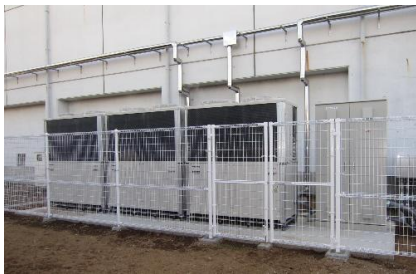
ガスエンジンヒートポンプエアコン
