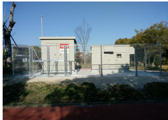
非常用発電設備の整備
