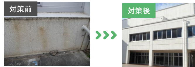
漏水の防止・壁剥落の防止
