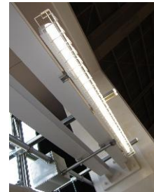
非常用コンセント
