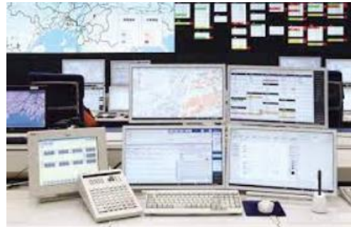
消防指令システム 指令台の構成 写真: 岡崎幸田消防指令センター
