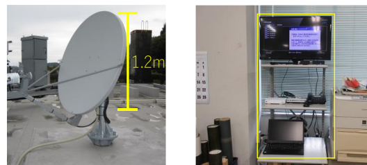
第3世代システムの衛星通信機器 (アンテナ、室内機器ともに小型かつ低コスト)
