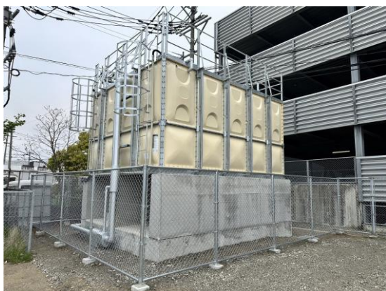
給水設備の整備等により、地震による断水時でも3日程度の診療機能を維持
