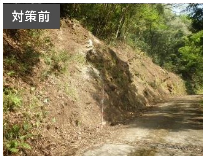
のり面が不安定な林道
