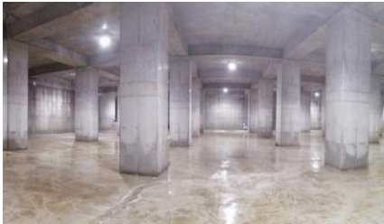
箱型や掘り込み式等の貯留施設で、管きよやポンプ等の排水能力不足を補完し、雨水を一時貯留する
