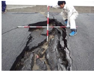
堤防法面の陥没
