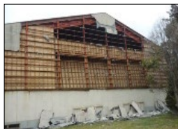
外壁の全面的な脱落事例
