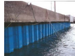
岸壁、鋼製矢板の腐食対策
