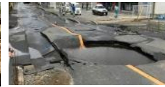
地震による管路の被災状況
