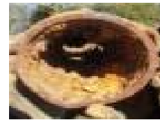
管路の老朽化が進行
