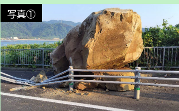
国道220号の落石 (R6.8地震(宮浦地区))
