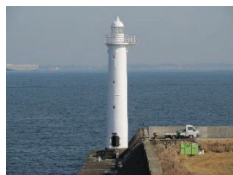
①四日市港防波堤灯台 監視カメラを灯台に設置
