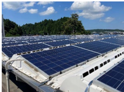
令和6年能登半島地震で機能発揮した太陽光発電設備(珠洲市役所)
