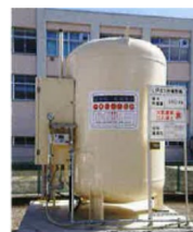
LPガスタンク
