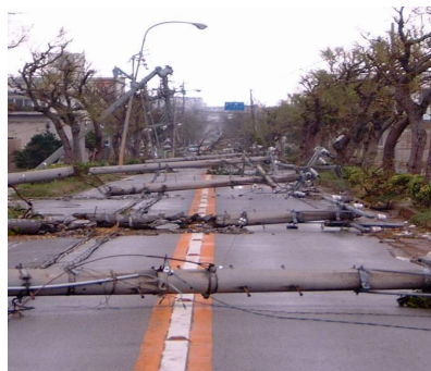
電柱の倒壊による道路閉塞
