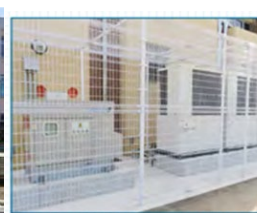
GHP及び非常用発電機
