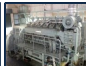
停電対策: 自家用発電機の整備
