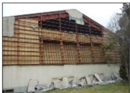
外壁の全面的な脱落事例
