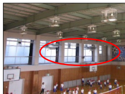
体育館への空調設置
