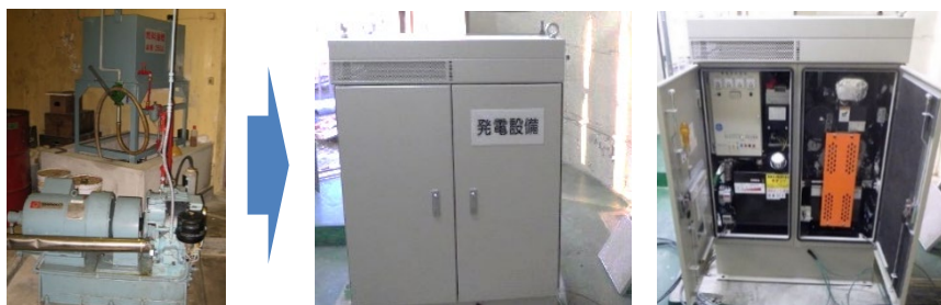
老朽化発電機の換装(72時間連続運転可能な発電機へ換装)
