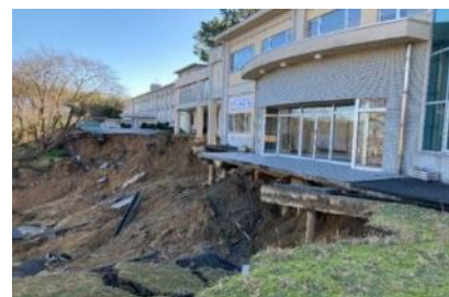
校舎前地盤が崩れ、地中杭が露出
