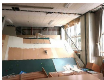
天井、内壁の落下
