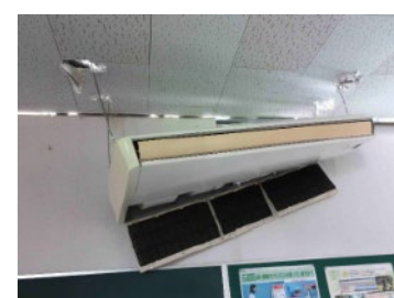
設備機器の脱落
