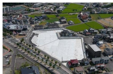
三次市による雨水貯留施設の整備 (江の川水系馬洗川)
