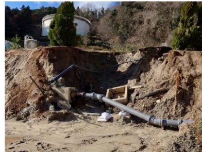
浄水場内の配管損傷(七尾市)
