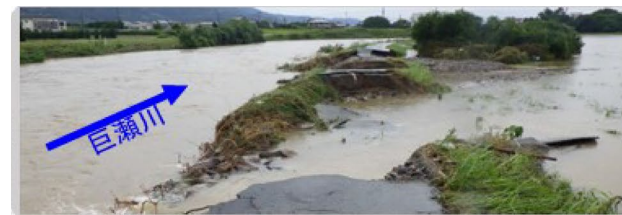
河川氾濫(R5.7豪雨)
