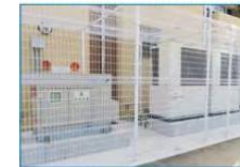
GHPと非常用発電機
