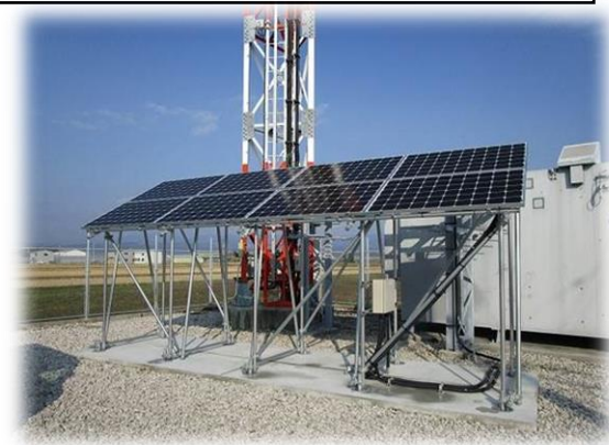
携帯電話基地局の太陽光パネル（NTTドコモ）
