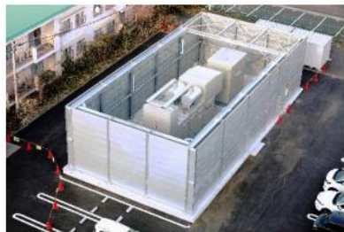
非常用自家発電設備（全景）
