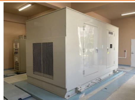
非常用自家発電設備
