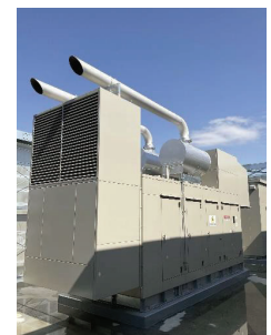
非常用自家発電設備(拡大)
