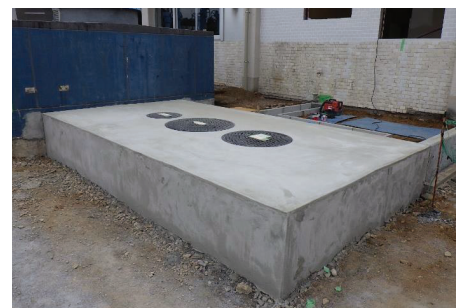
地下燃料タンク
