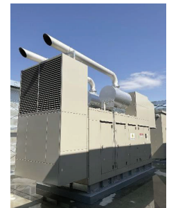
非常用自家発電設備(拡大)
