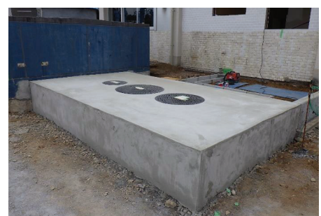
地下燃料タンク
