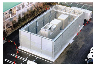
非常用自家発電設備(全景)
