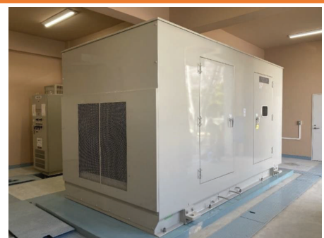
非常用自家発電設備
