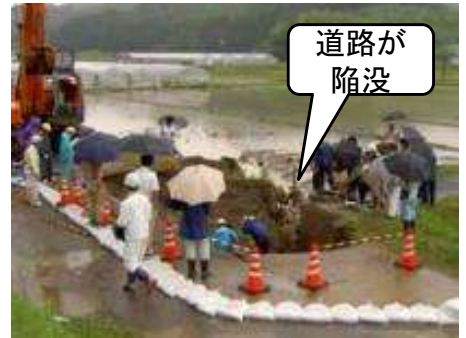
パイプラインの漏水 による道路陥没
