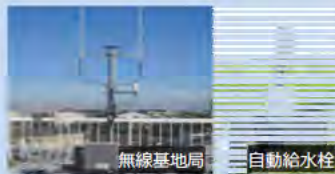
無線基地局 自動給水栓 情報通信環境の整備
