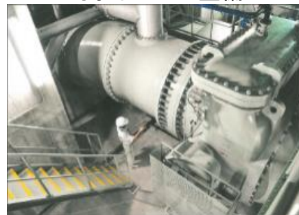
雨水ポンプの整備
