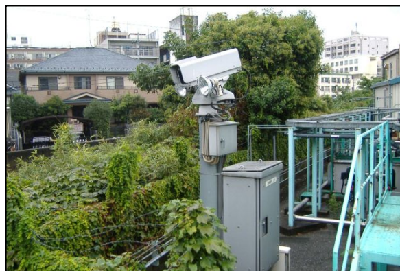
水位監視カメラ
