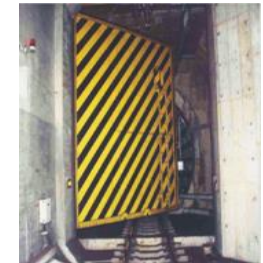
防水扉(トンネル内)
