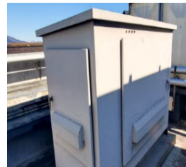
非常用発電設備
