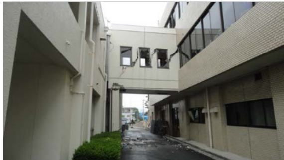
庁舎における構造部材の損傷
