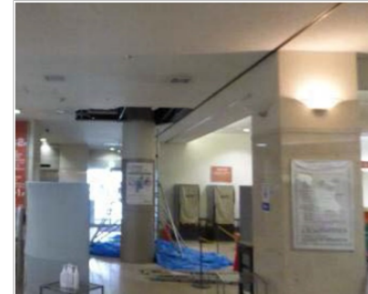
病院における天井の損傷
