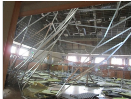
体育館における天井の損傷
