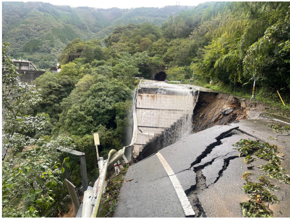
国道327号被災 塚原ダム付近 (諸塚村)
