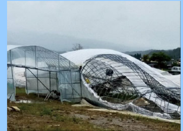
ハウス (ピーマン等) 損壊 (西都市)
