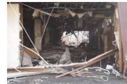
▲津波で一階が奥まで突き抜けた(金石商工会議所)
