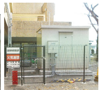
非常用自家発電機用 燃料タンク
