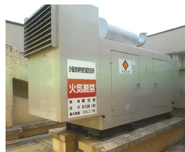
非常用自家発電設備本体
