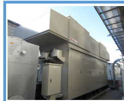
天然ガスコージェネレーションシステム
