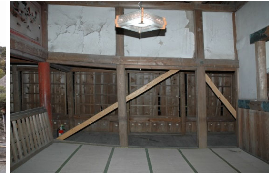
本堂内部(修理前) 東日本大震災で被災し、柱が傾斜
