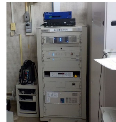
衛星通信装置(白石市庁舎)
