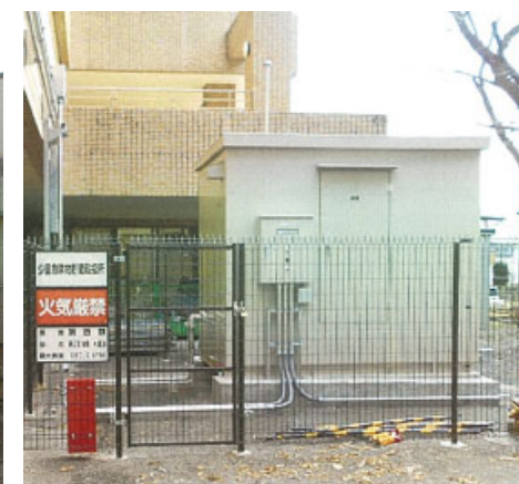
非常用自家発電機用 燃料タンク
