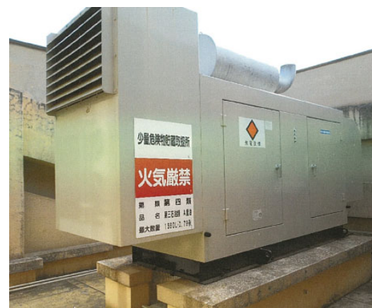
非常用自家発電設備本体
