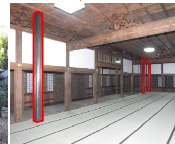
本堂内部(修理・補強後) 鉄骨フレーム(赤囲み部分、木カバー付)による耐震補強を実施
