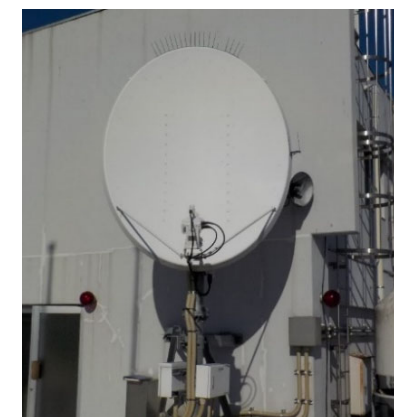
衛星通信アンテナ(白石市庁舎)
